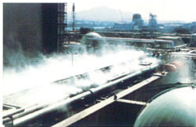
パイプヤード散水設備
