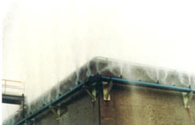
防油堤水幕設備
