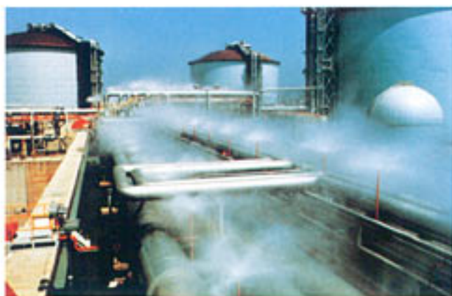
ラック散水設備
