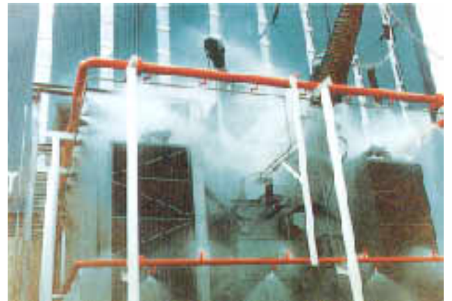
トランス水噴霧設備
