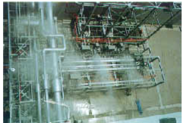
化学プラント水噴霧設備
