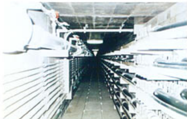
ケーブル洞道散水設備
