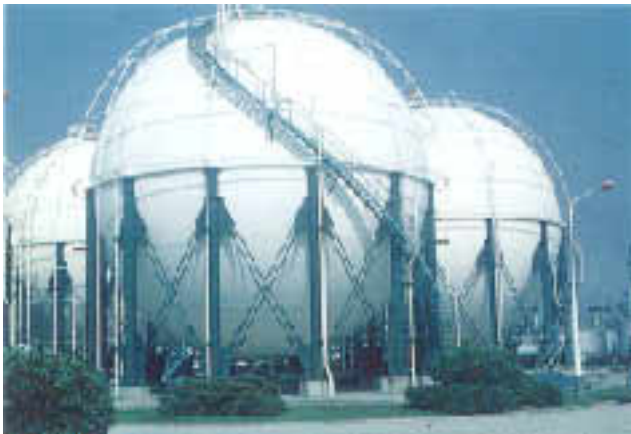
液化石油ガスタンク水噴霧設備
