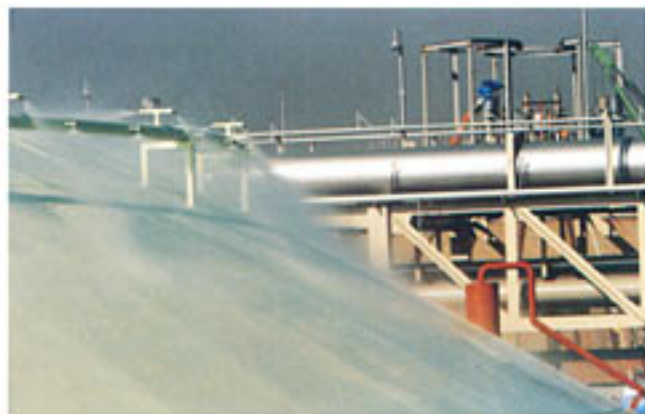
タンク散水設備
