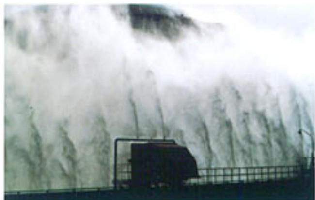
タンクヤード水幕設備
