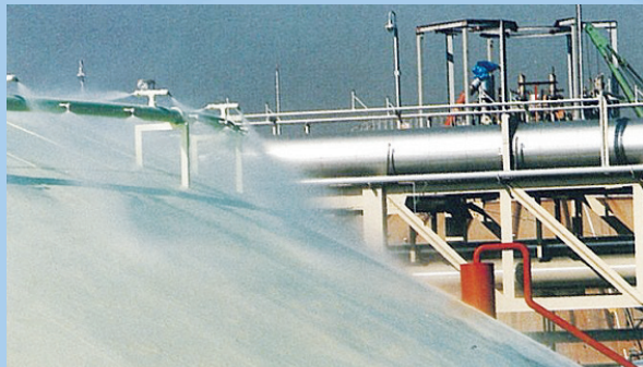
タンク散水の状況
