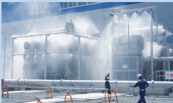
水噴霧設備設置例
