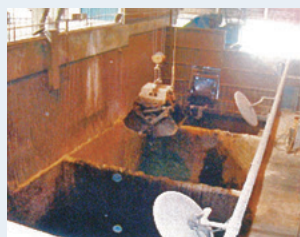
RPF施設の特殊水噴霧設備
