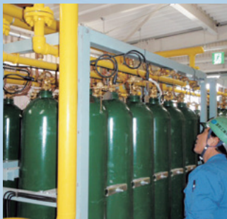
二酸化炭素消火設備
