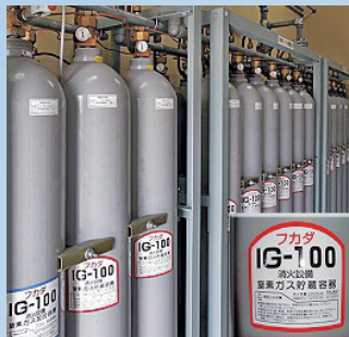
IG-100消火設備
