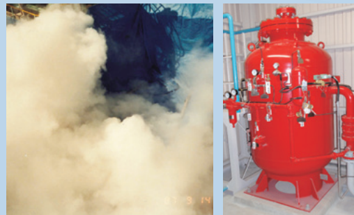
粉末消火設備
